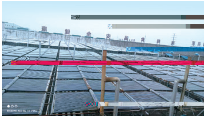
太陽能集熱設備
