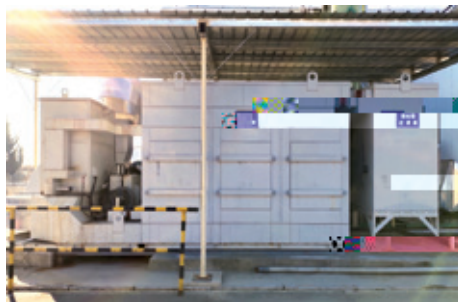
有機廢氣催化燃燒淨化裝置
