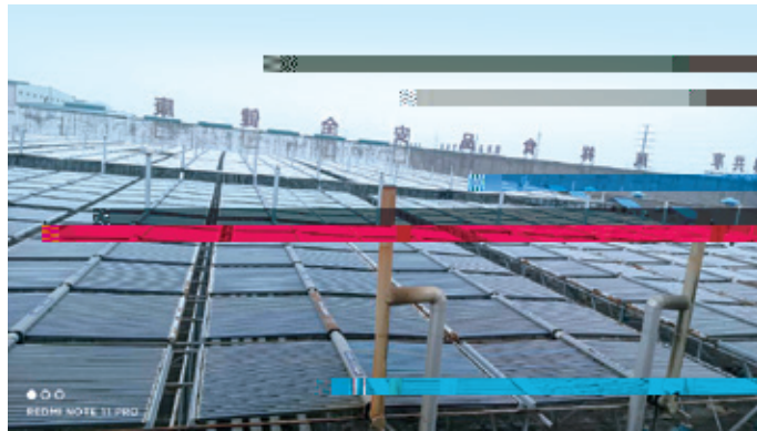
太陽能集熱設備
