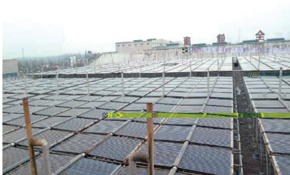
太陽能集熱設備
