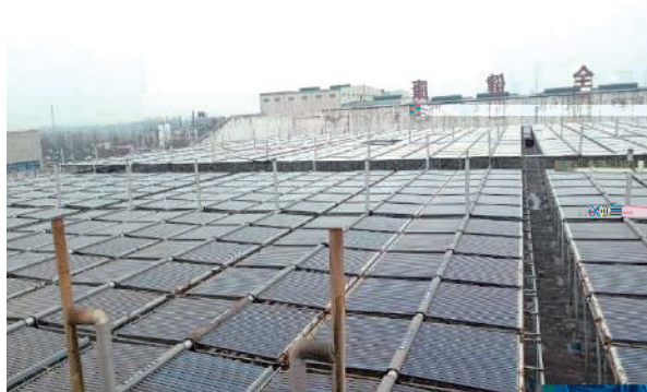
Solar Collectors 太陽能集熱設備
