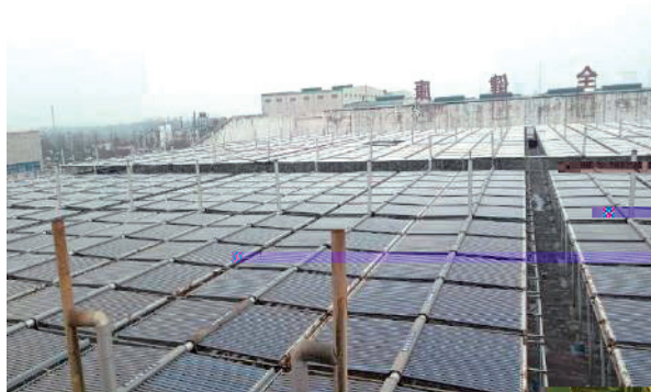
Solar Collectors 太陽能集熱設備
