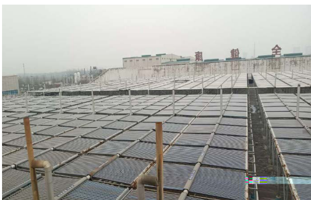
Solar Collectors 太陽能集熱設備
